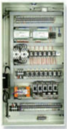
電控箱裝置 Electrical Cabinet
